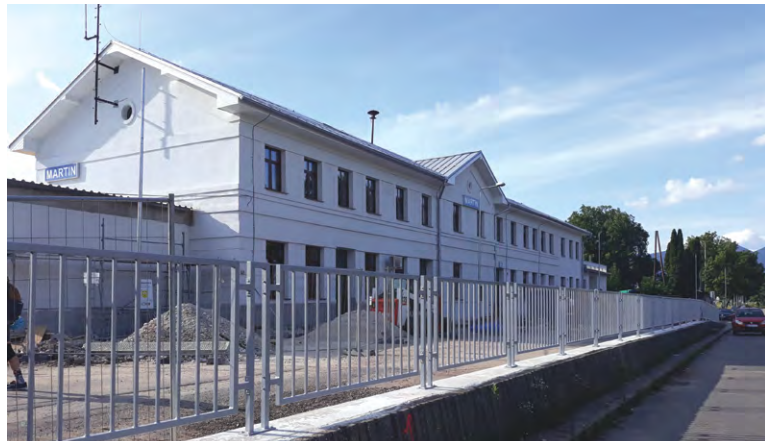
Fasády sú hotové, aj ochranný múr s plotom v popredí, na rade je parkovisko.
