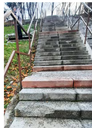
Schody na Ľadoveň začínajú „odchádzať“.
