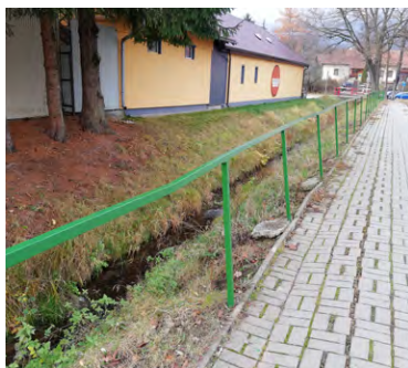
Zdeformované zábradlie a chodník pri kanáli. Foto: lch
