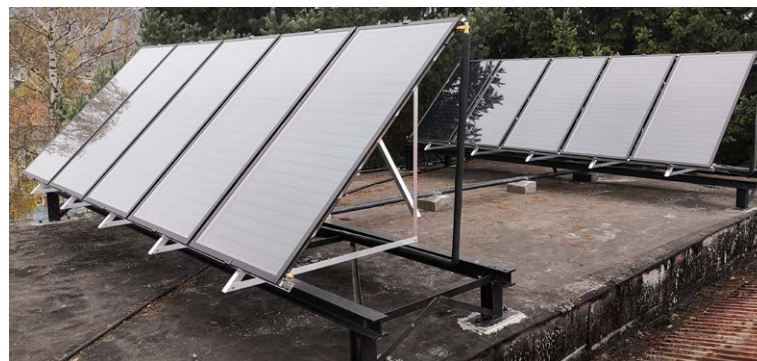
Na futbalovom štadióne sa bude využívať slnečná energia. Foto:mv
