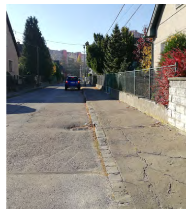
Chodníky v mestských častiach (napr. aj na Rastislavovej ul. na Starej Ladovni) by sa mali opraviť čo najskôr. Foto: l'ch
