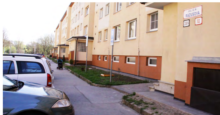
Na Rázusovej ul. bude opravený chodník i vstupy do vchodov. Foto: jf
