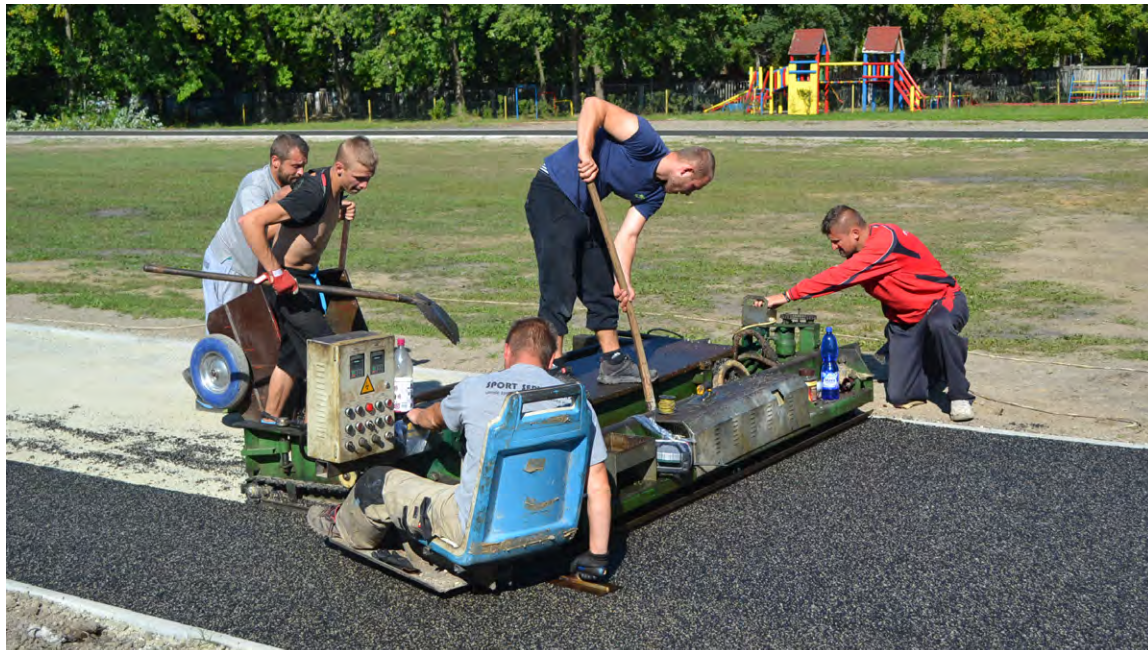
Pýchou školy je aj novovybudovaný športový areál. Zábery z výstavby atletickej tartanovej dráhy (30. 9. 2016).
