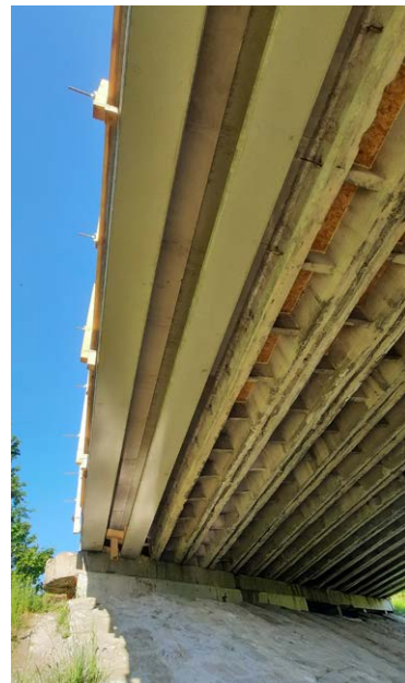
Vľavo dva nové nosníky, ostatné - škoda reči...
