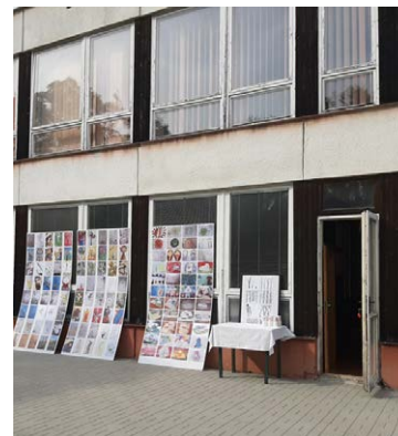
Budova školy by tiež potrebovala rekonštrukciu
