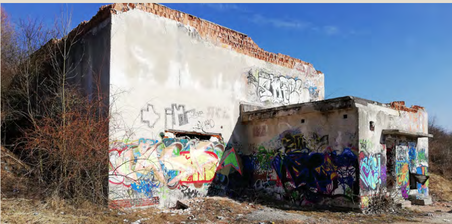
Objekt vodojemu je ruina, s ktorou je potrebné niečo urobiť
